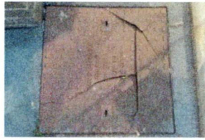
MH10 BROKEN COVER.JPG
