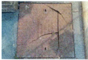
MH10 BROKEN COVER.JPG
