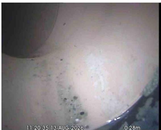
MH12 (F35)X_4e2e42c5-9a6c-4f90-afbd-c80d628e3121_20260917_165124_557.jpg, 00:01:05, 0.28 m Line deviates left
